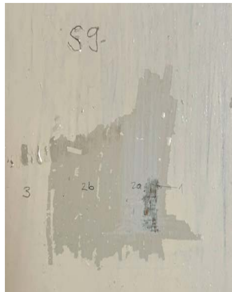
Abb. 68: Sondierung auf Türfüllung. 1 = älteste Fassung grüngrau. 2a/2b = zweite Gestaltungsphase. 3 = aktueller Anstrich.
