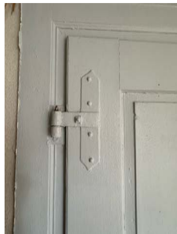
Abb. 38: DG. Kreuzband. Bauzeitlich.
