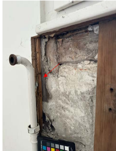
Abb. 111: Sondieröffnung Westwand. Älteste Tapete wurde direkt auf den Putz geklebt (erste Gestaltungsphase).
