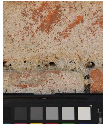
Abb. 12: Reste von Verputz und Hackspuren auf den Backsteinen der Westfassade.
