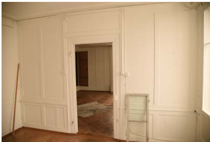
Abb. 97: Westwand. Knietäfer älter als obere Täfer-Zone.
