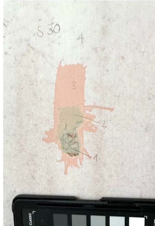
Abb. 94: Sondierung Ostwand, Knetäfer Füllung. Sondiert hinter demontiertem Heizkörper. Daher: Fassungen älter als Zentralheizung.
