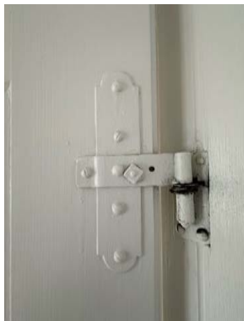
Abb. 37: DG. Kreuzband. Bauzeitlich.
