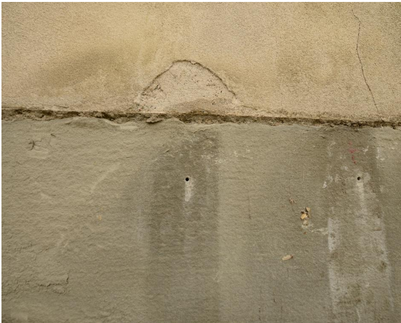
Sockelbereich Sandstein Sockel teilweise mit Zementputz überdeckt
