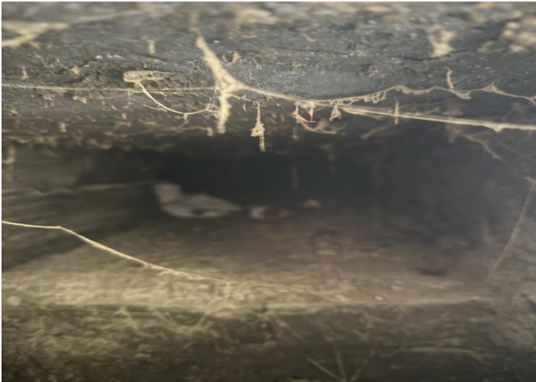
Starke Verschmutzungen und Ablagerungen im Rauchkanal.
