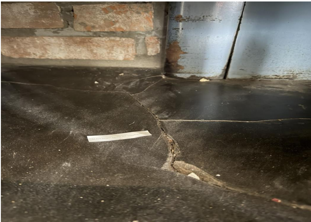
Risse und Schäden an der keramischen Ofenplatte.
