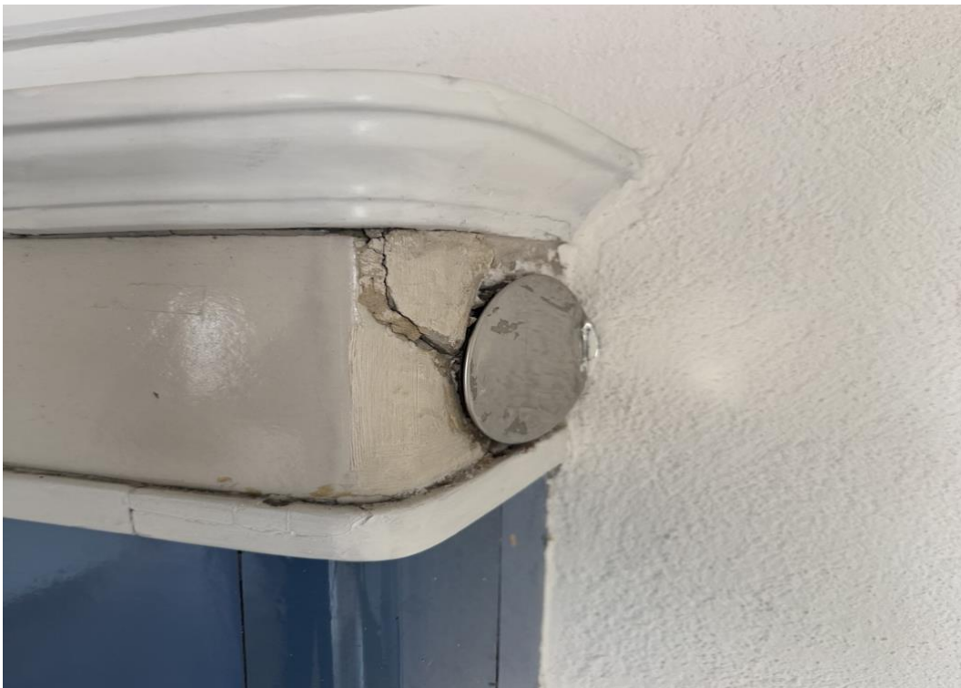
Rissbildung im oberen Bereich der Ofenverkleidung.
