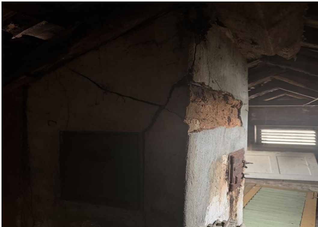
Rissbildungen und Schäden im Bereich des Kamins.
