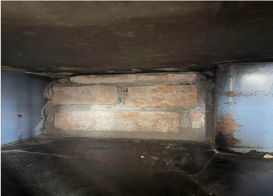
Unfachmännisch zugemauerter Bereich am Kachelofen.
