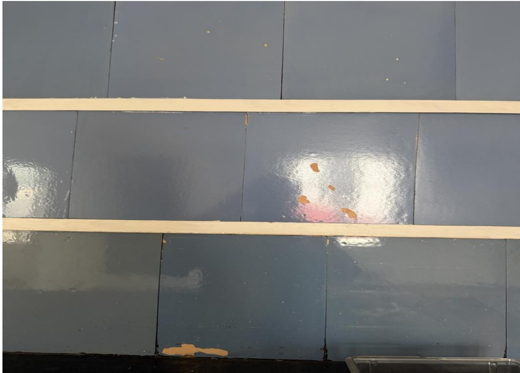
Abplatzungen und beschädigte Kachelflächen.
