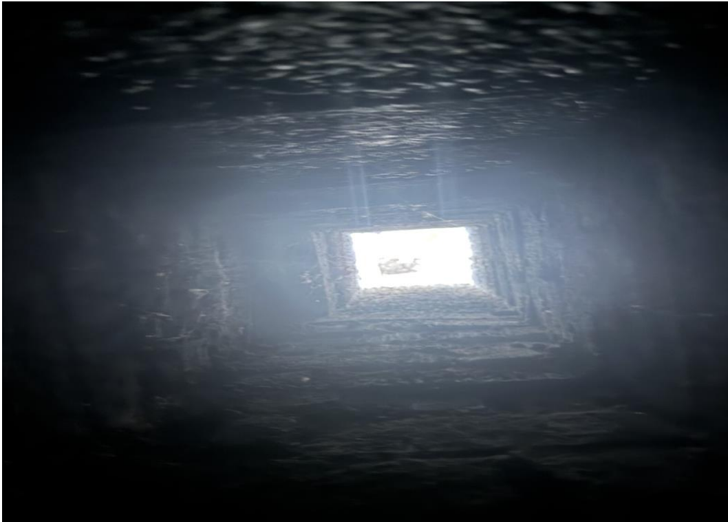
Innenansicht des Kaminzuges mit starken Ruß- und Teerablagerungen.
