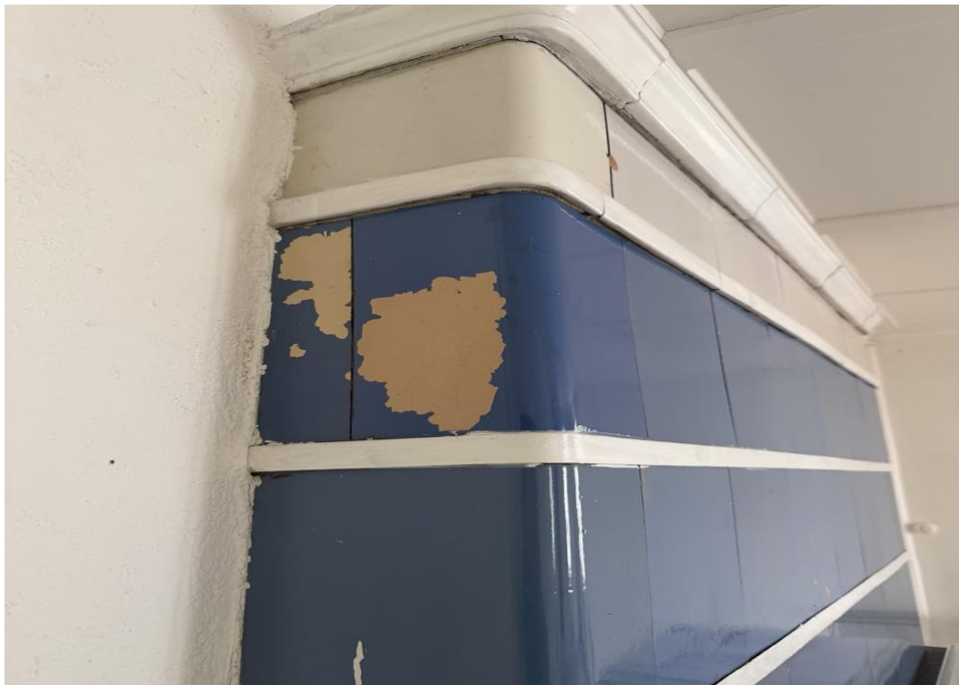
Beschädigte Eckbereiche mit Ablösungen der Oberfläche.
