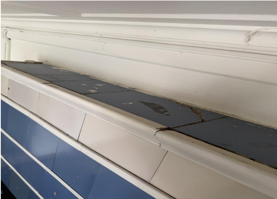
Beschädigte Kacheloberflächen und offene Fugen.
