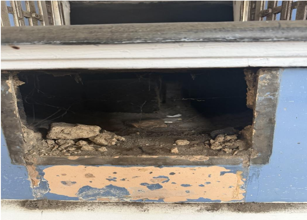
Beschädigte Feuerraumöffnung mit Ablagerungen und Materialschäden.
