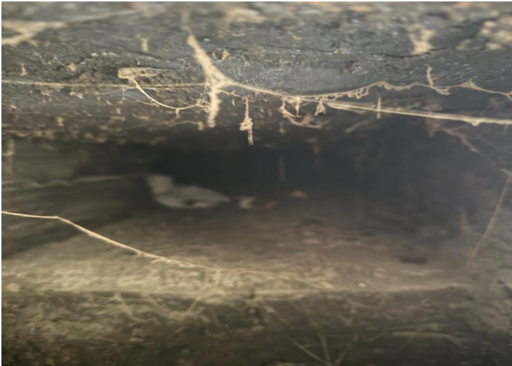
Staub- und Ablagerungsbild innerhalb der Kanalanlage.
