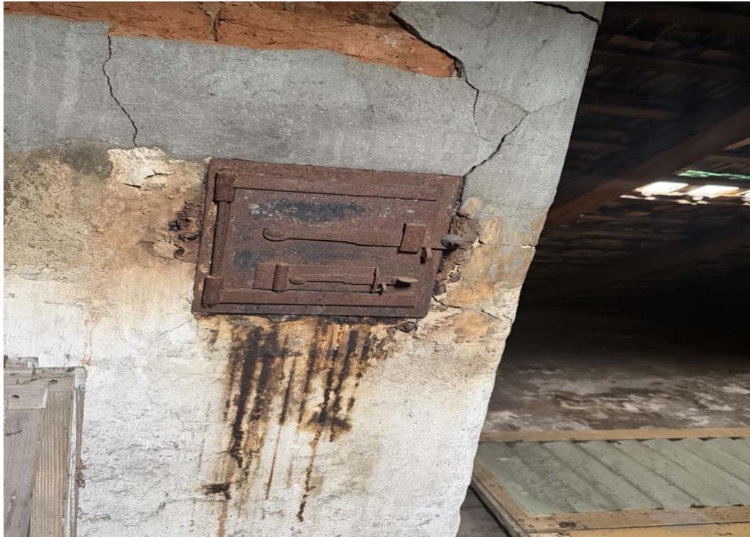
Korrodierte Revisionsöffnung und beschädigte Mauerwerksbereiche.
