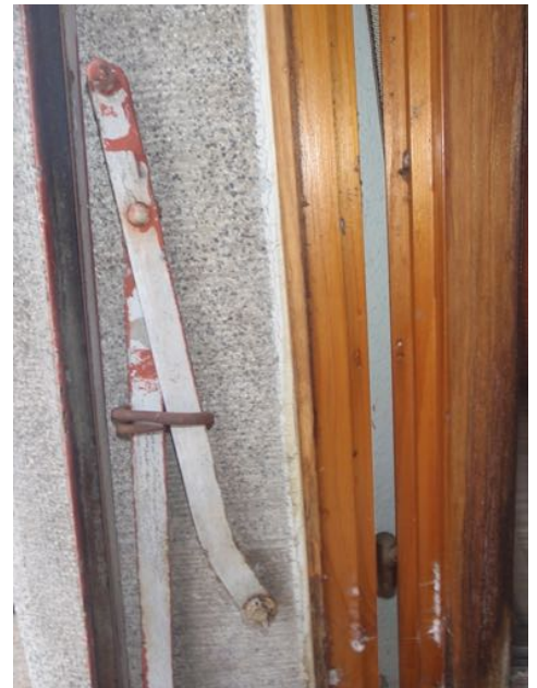
Anschlagkitt mit Asbest (zwischen Fensterrahmen und Mauerwerk)
