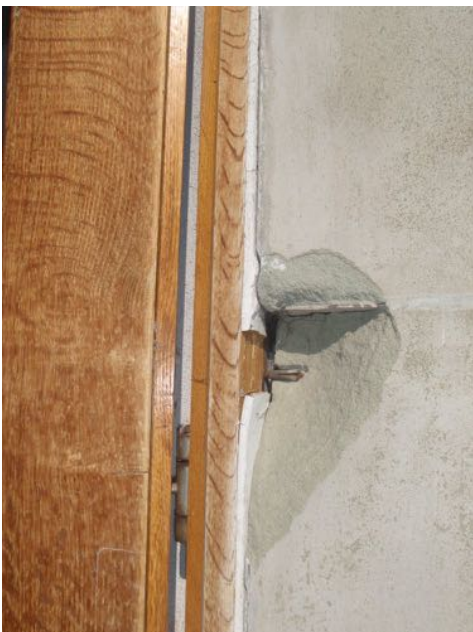
Anschlagkitt mit Asbest (zwischen Fensterrahmen und Mauerwerk)
