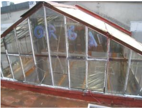
Photo Glasdach mit asbesthaltigem Fensterkitt
