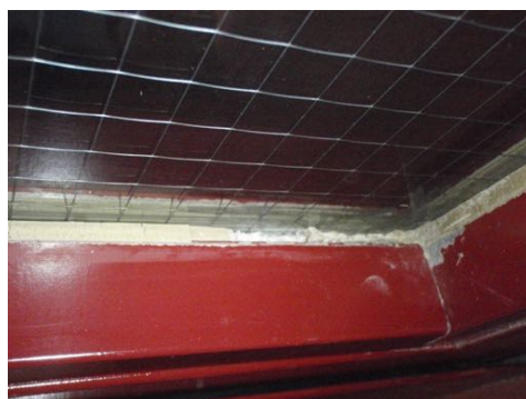
Brandschutztüre mit Asbestschnur unter Fensterkitt
